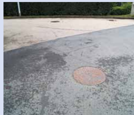
Tyto kanalizační vpusti se budou opravovat
