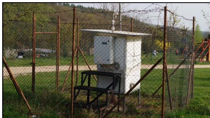
Automatická monitorovací stanice - Sídliště Mokrá
